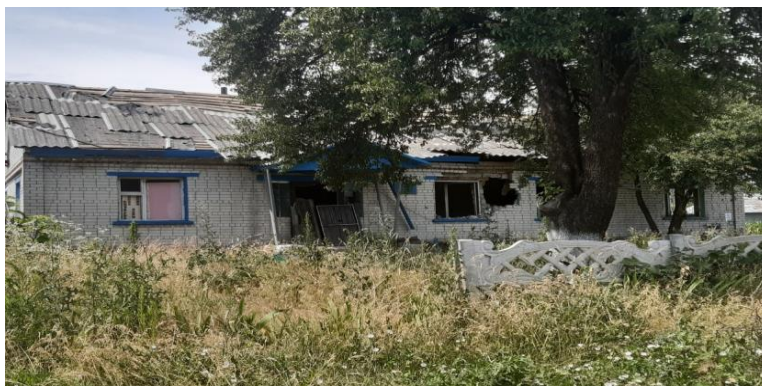
Фото 4. Пошкоджена будівля сільської ради від техніки
